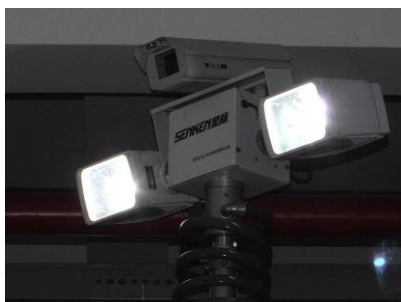
摄像机两侧高亮度照明灯
